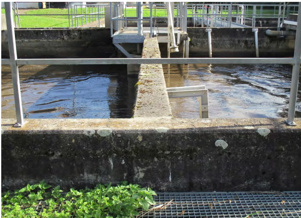
Abb. 17: Blick auf die Trennwand zw. DN 2 und N 2 mit außen sichtbaren Kalksinter- spuren an Rissen in der Wandkrone
