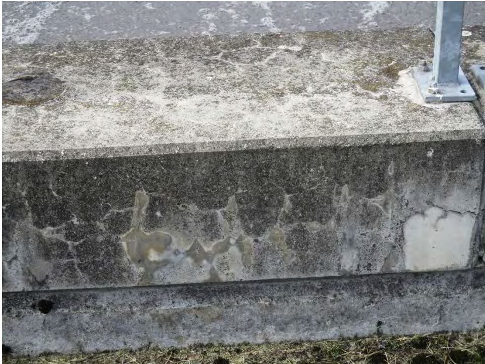
Abb. 14: Betonschäden an einem Betonfertigteile
