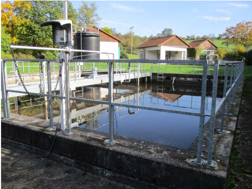
Abb. 12: Blick auf das Nitrifikationsbecken 1
