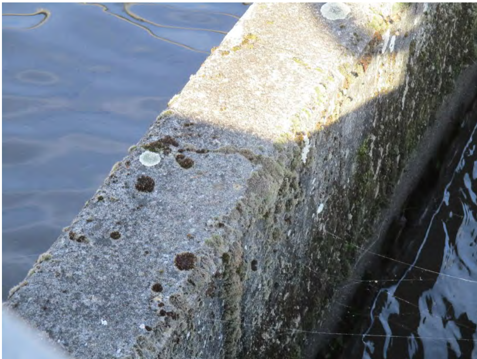
Abb. 11: Blick auf eine Wandkrone im Denitrifikationsbecken 2 mit Moosbewuchs
