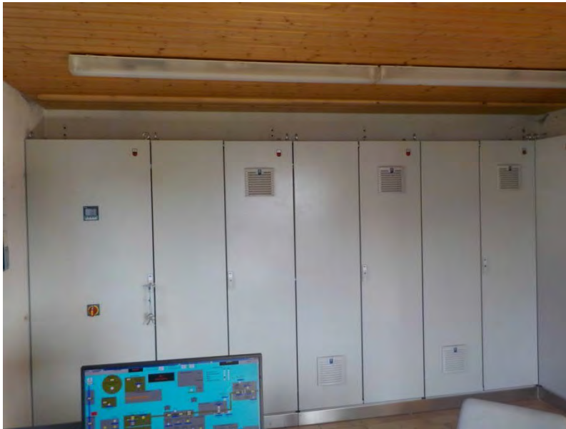
Abb. 5: Bestehende Schaltanlage mit Arbeitsplatz Prozessleitsystem
