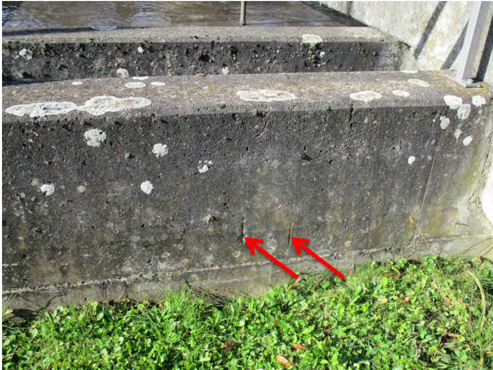
Abb. 10: Freiliegende Bewehrung an der Beckenaußenseite
