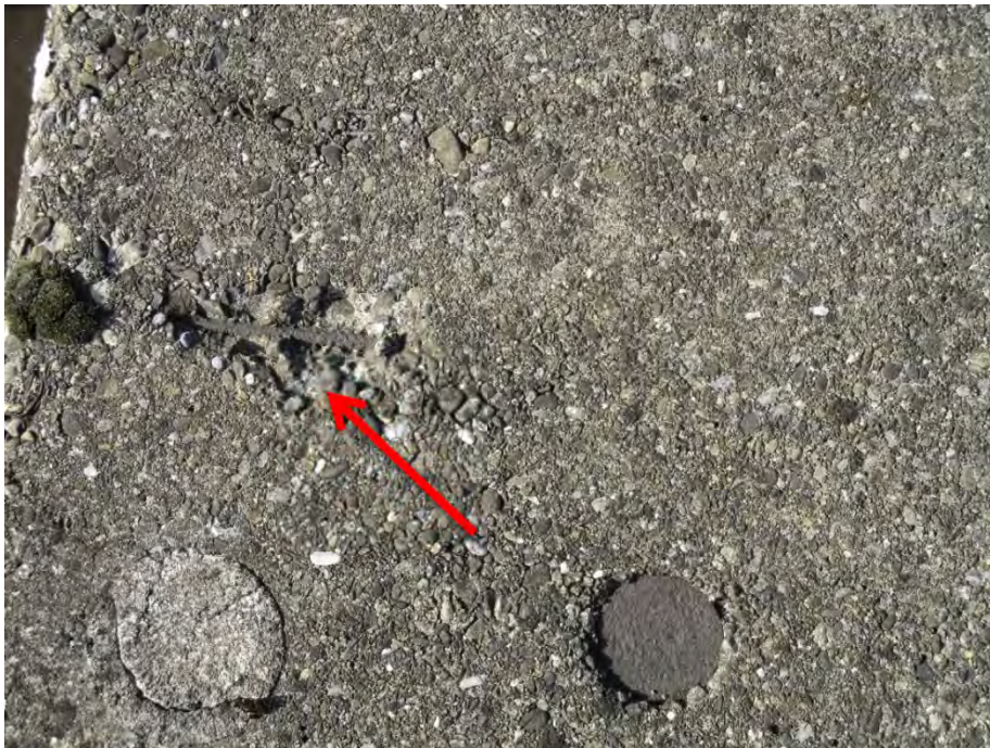
Abb. 9: Freiliegende Bewehrung auf der Stegoberseite
