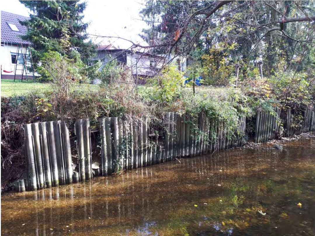
Faserzementplatten (asbesthaltig) Untere Steinstraße 44
