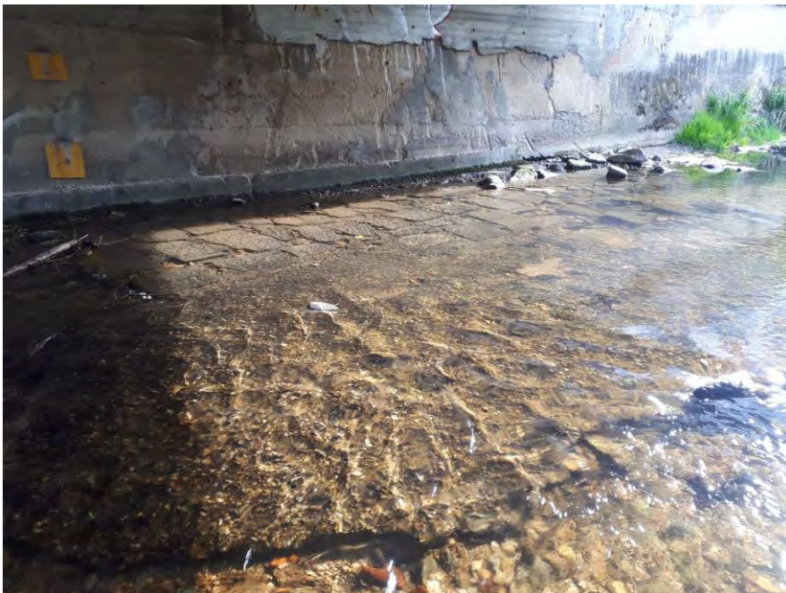
Hart verbaute Gewässersohle ohne Substratauflage im Brückenbereich
