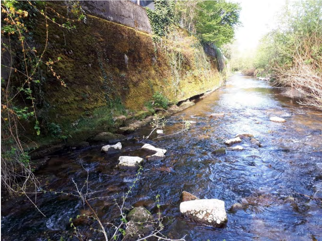
Strukturierte Gewässersohle unterhalb Brücke, beginnende Unterspülung an linker Ufermauer
