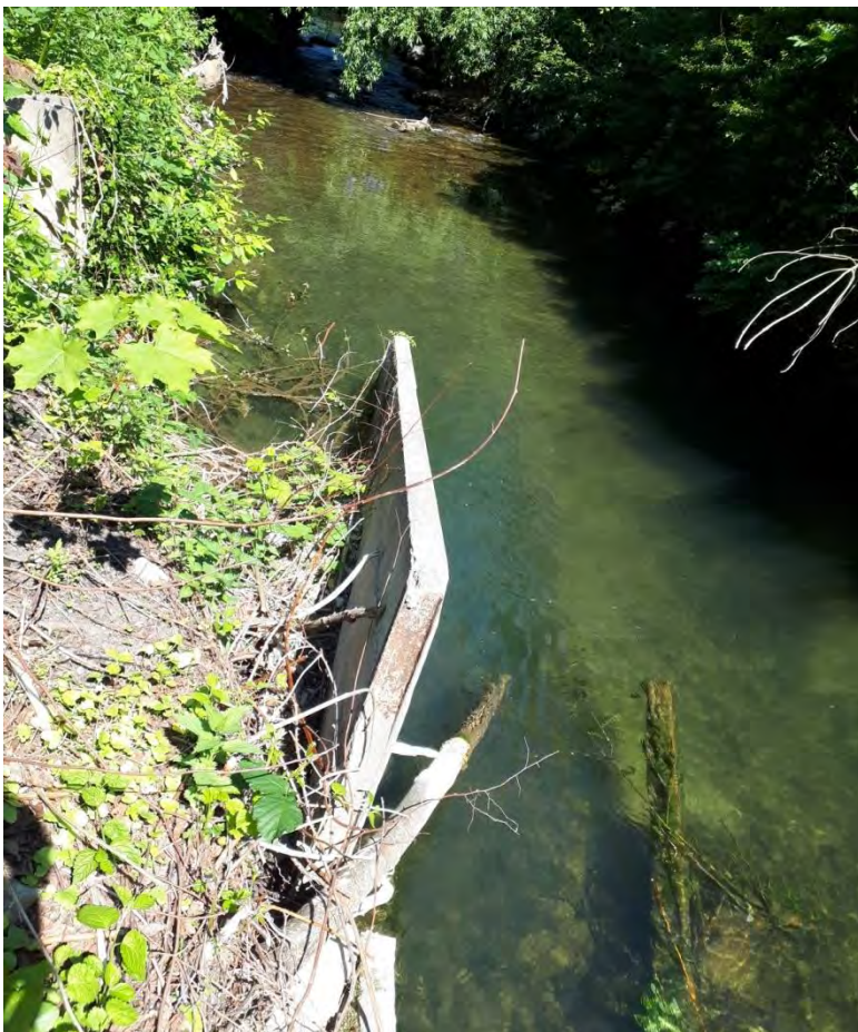
Neue Schäden durch fortschreitende Unter- und Hinterspülungen (Aufnahme 2019)
