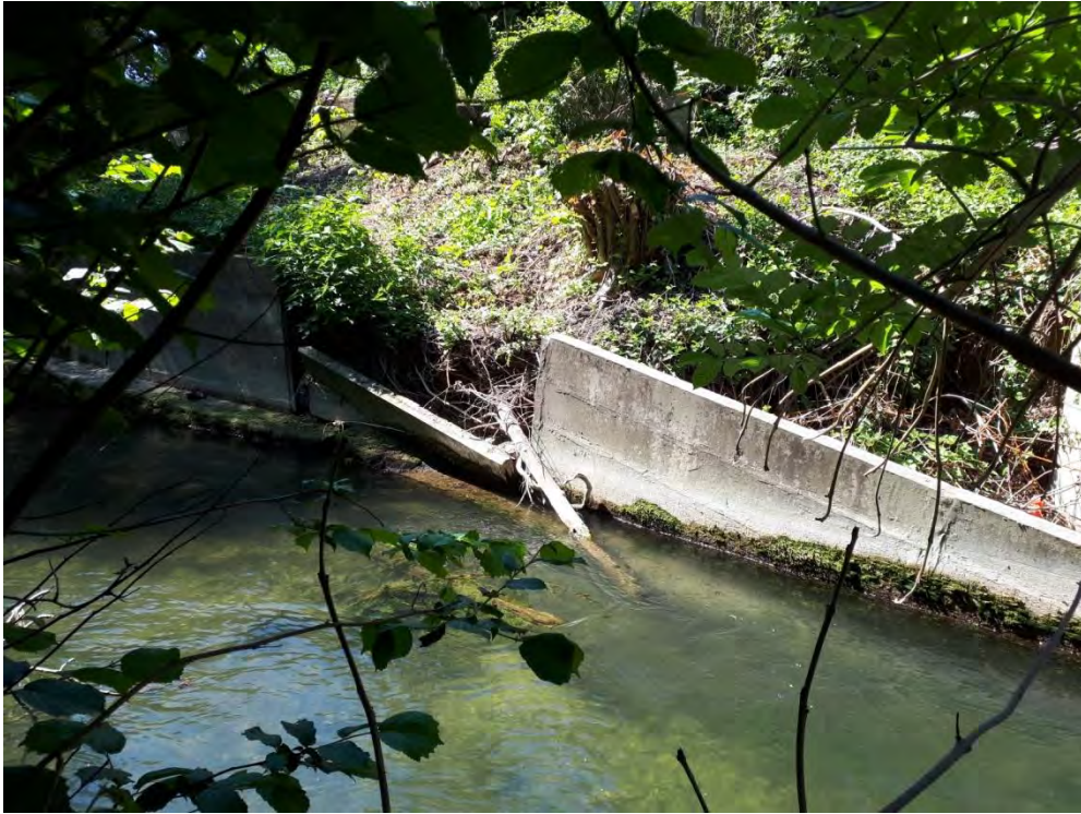
Neue Schäden durch fortschreitende Unter- und Hinterspülungen (Aufnahme 2019)
