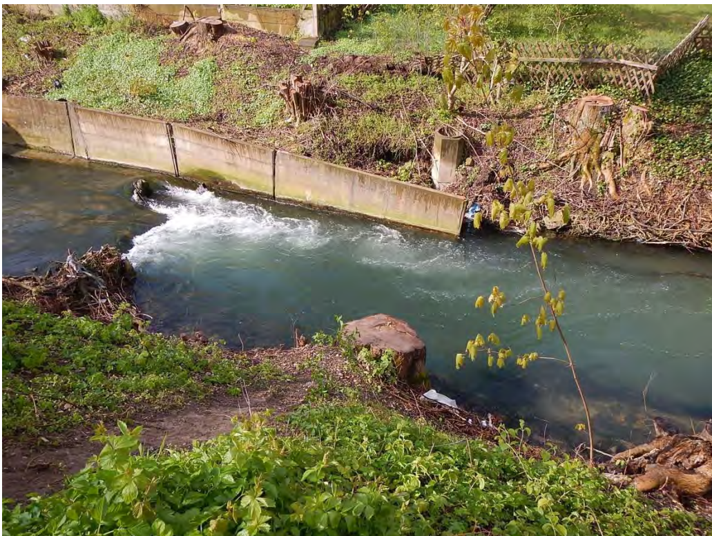
Unter- und Hinterspülung im Bereich Absturz/Tosbecken (Aufnahme 2016)
