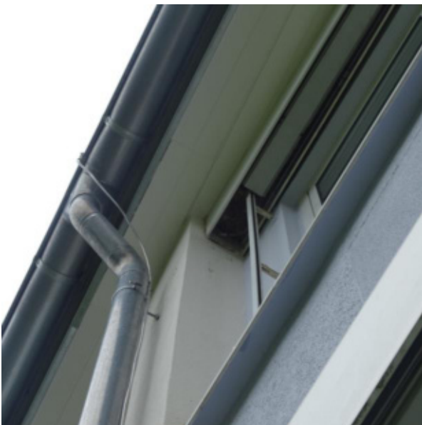
Abb. 7: Die offenen Jalousienkästen am Schulgebäude werden vom gefährdeten Haussperling zur Brut genutzt.
