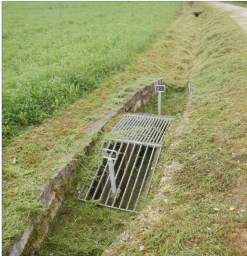
Abbildung 5.7 Einlaufbereich der Verdolung 37 (Stand: Ortsbegehung am 16.06.2020)
