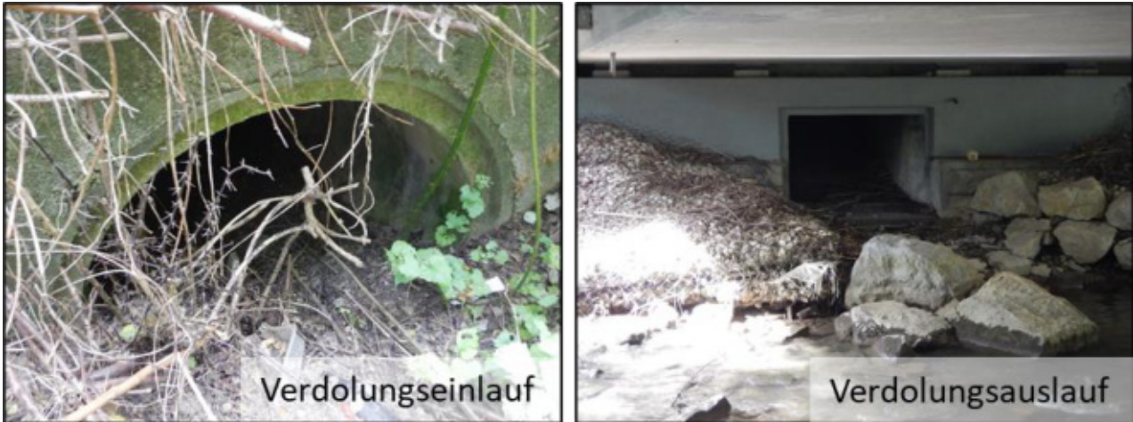
Abbildung 11.6 Zustand des Verdolungsein- und auslaufs bei der Ortsbegehung am 09.07.2020
