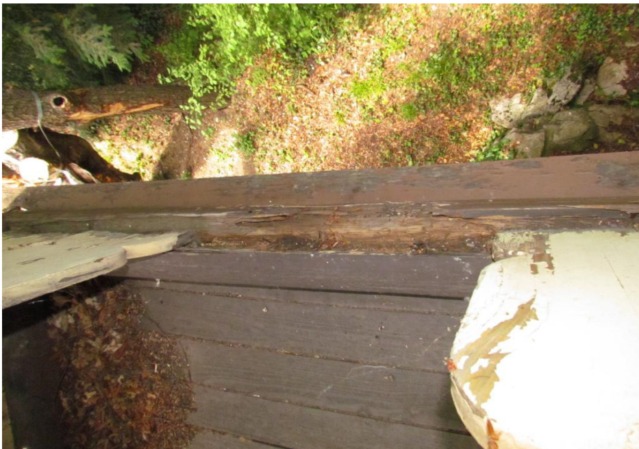
Bild 18: Unterer Geländerriegel (Holm), Nord - West, BT 138
