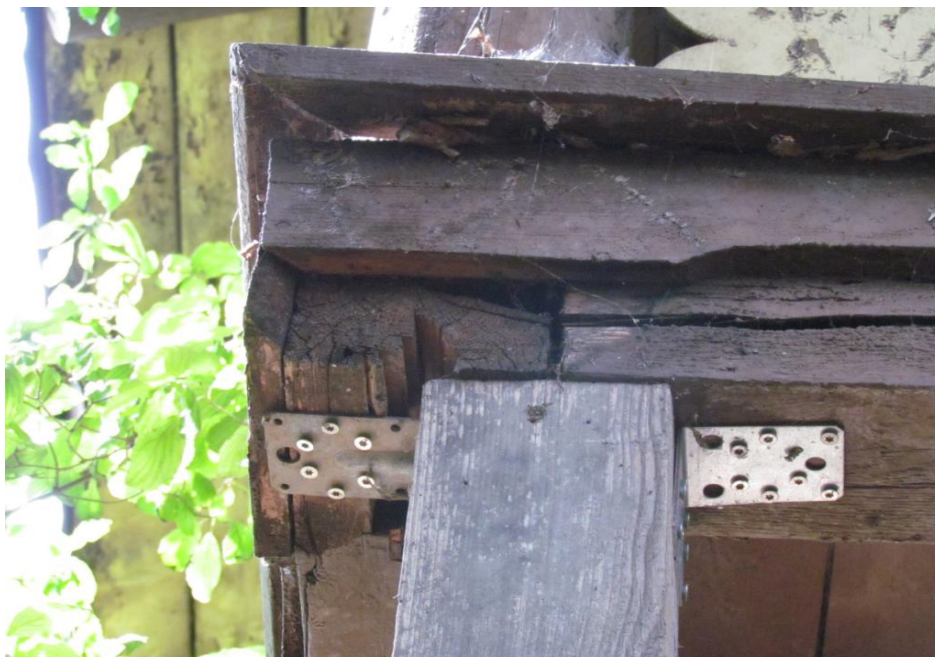
Bild 30: Eckstütze, Ostecke, BT 83, von aussen
