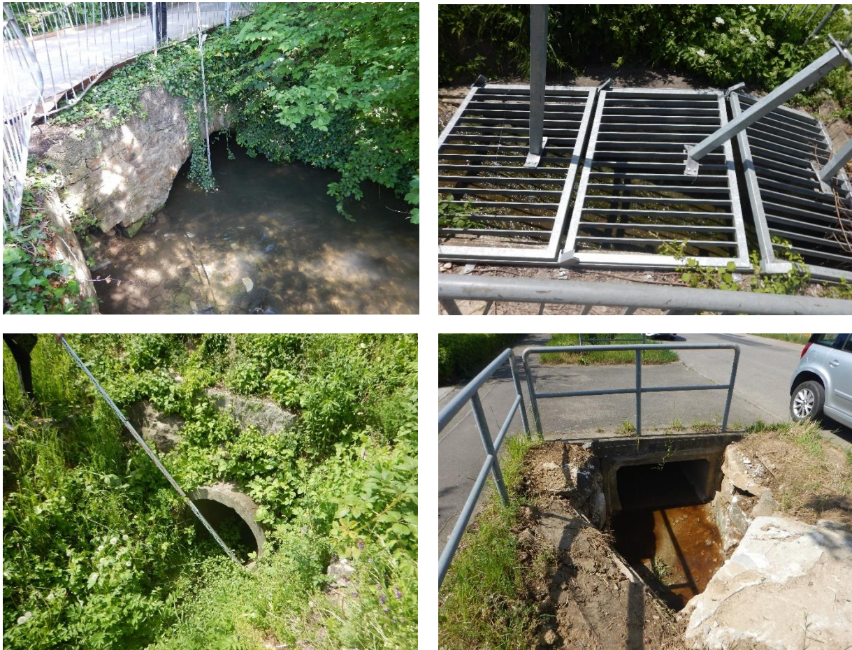
Abbildung 5.9: Links oben Verdolung 7 am Fabrikkanal, rechts oben Verdolung 39 beim Kegelesbach, links unten Verdolung 45 nahe dem Dornbrunnenbach, links unten Verdolung 51 am Graben 2
